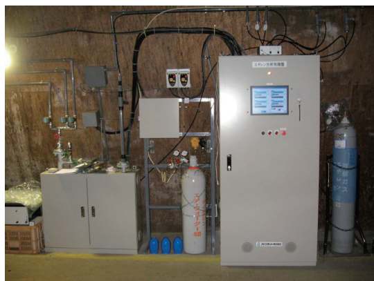
写真1 エチレン制御盤、エチレン調整器等 外観 (三菱電機冷熱プラント㈱)
