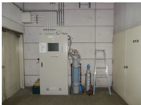
写真1 エチレン濃度制御装置 上部の配管よりエチレンガスが貯蔵庫内に供給される。
