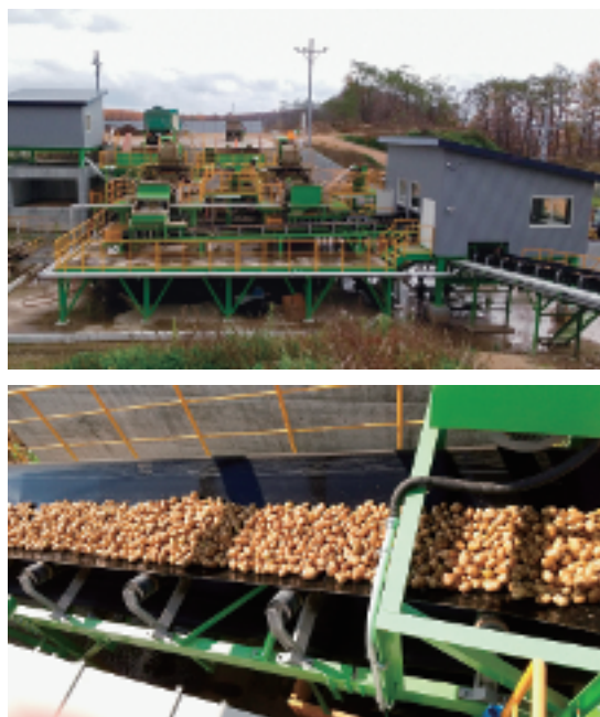
写真2. 工場再編事業で整備されたビホロ農工連の原料受入設備
